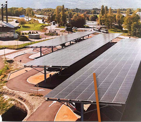
Parking de l'aire de covoiturage, en partenariat avec la Communauté de Communes et l'AREA
